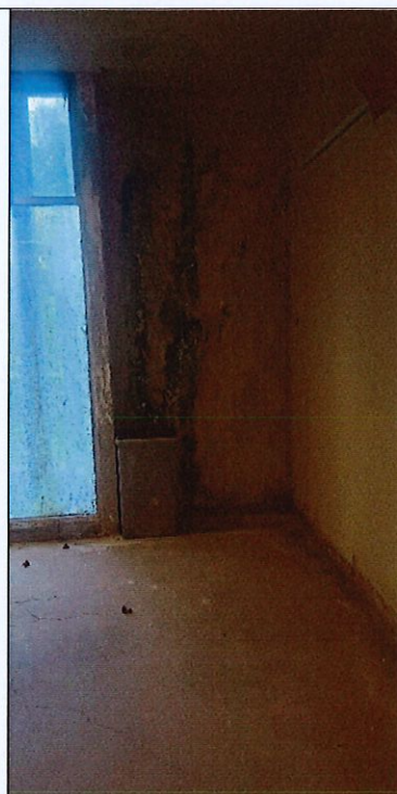
Algunos ejemplos de los efectos de la humedad y las filtraciones.
