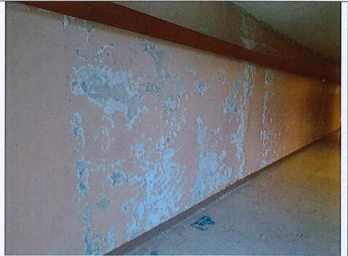
Efectos de la humedad y filtraciones.
